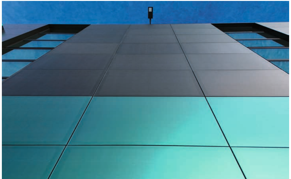
Die PV-Anlage der Fassade generiert mit einem Flächenanteil von rund 900 \text{ m}^2 140 kWp. Sämtliche vertikalen PV-Module (grün und anthrazitfarben) sind 1634 mm breit und 1111 mm hoch.
